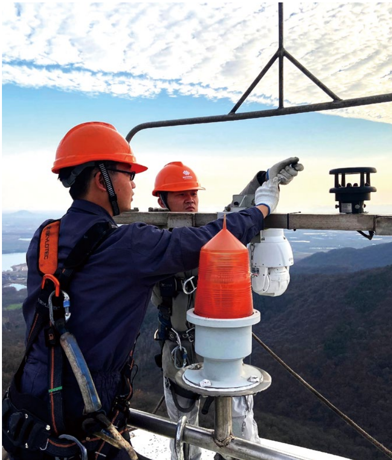
員工在風機機艙外安裝全域攝影機
